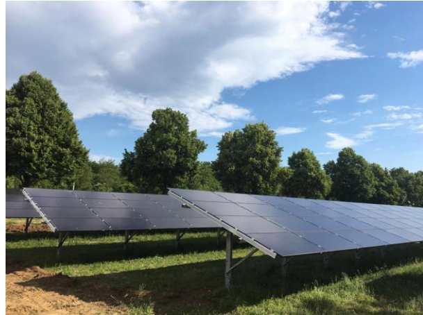
Source : réalisation par ELECTRO-CENTER s.à r.l. à Grevenmacher
